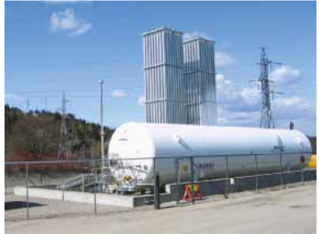
Figure 6 An LNG storage tank and evaporators, Source: Wikimedia Commons
